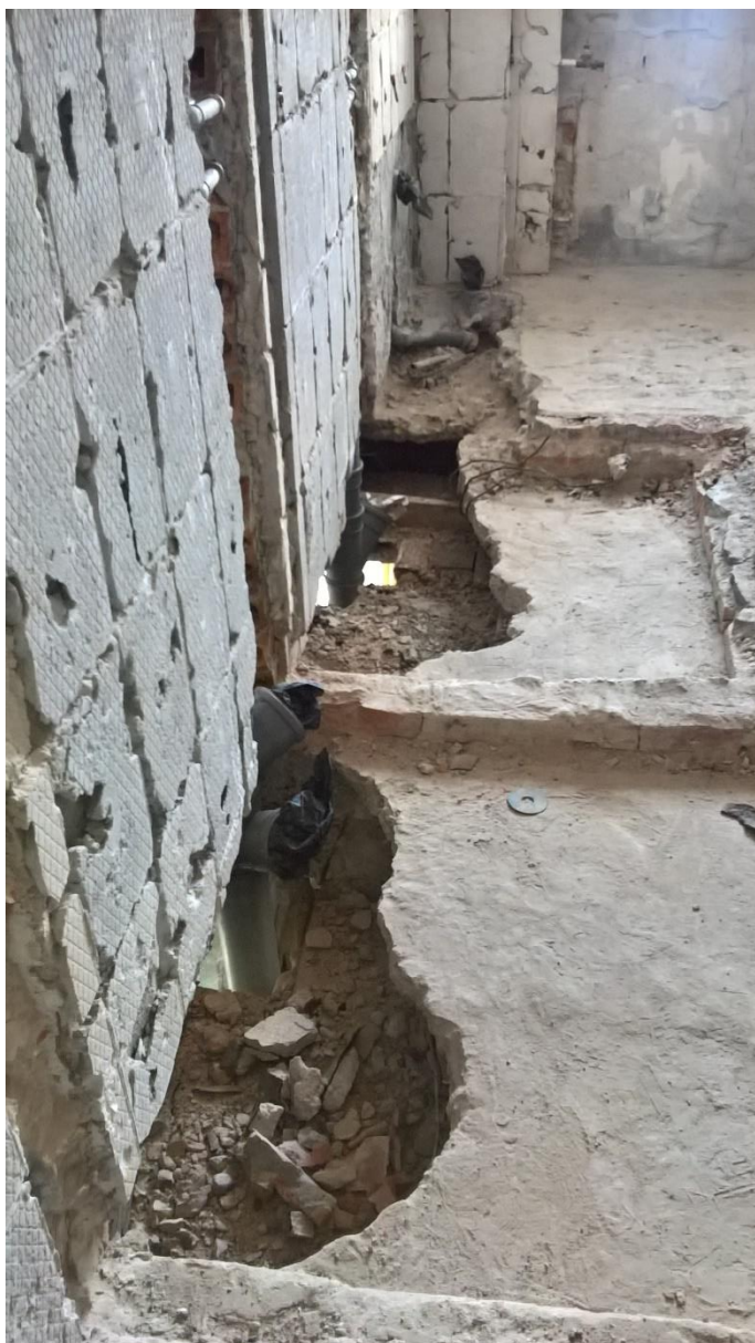
Zdjęcia stropu wymagającego naprawy – do pkt. 10 opisu przedmiotu zamówienia.
